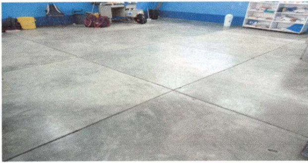
Foto 3: Piso de dos aulas deterioradas
