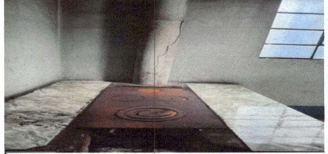
Foto 6: Plancha y chimenea deterioradas.
