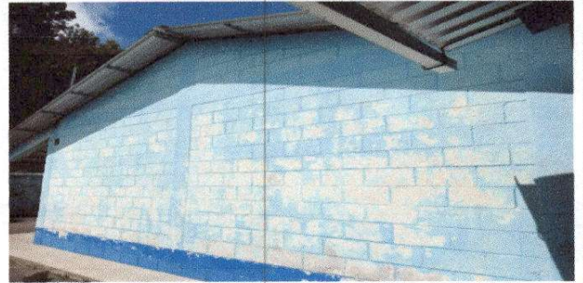
Foto 2: Pintura de las paredes aulas deteriorada.
