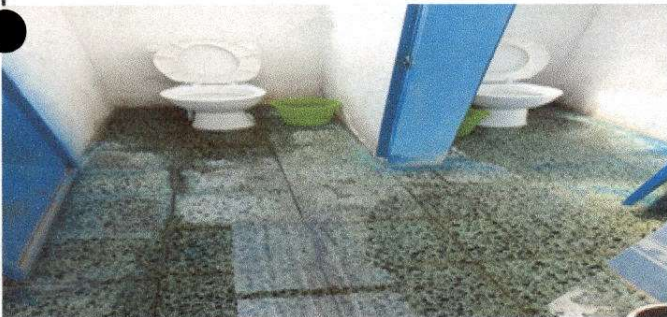
Foto 5: Accesorios de baños en mal deteriorados
