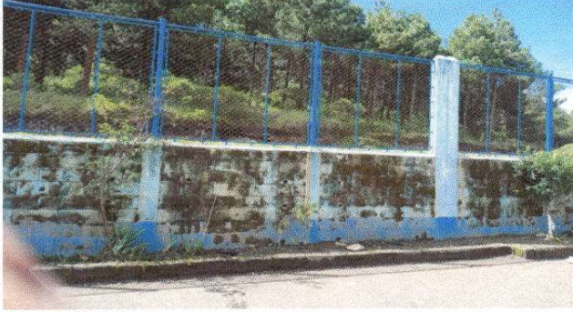
Foto 1: Pintura de pared de circulación en mal estado.
